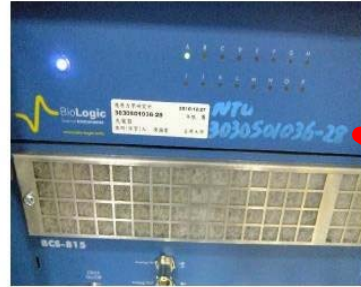
模組式電池充放電設備-財產貼牌
